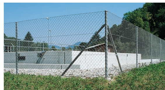
Diagonaldrahtgeflecht-Zaun mit Rohrpfosten
